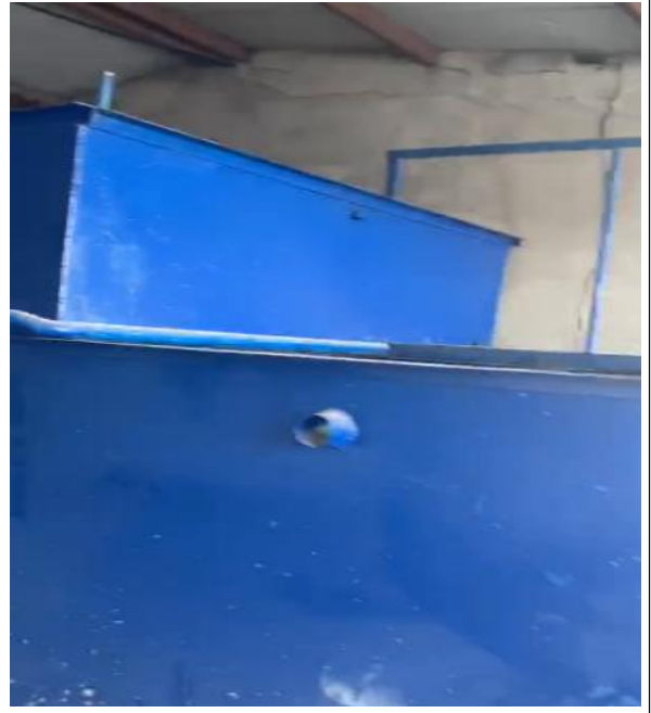
污水处理设施
