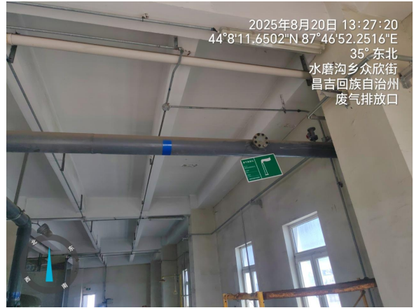
废气排口标识牌
