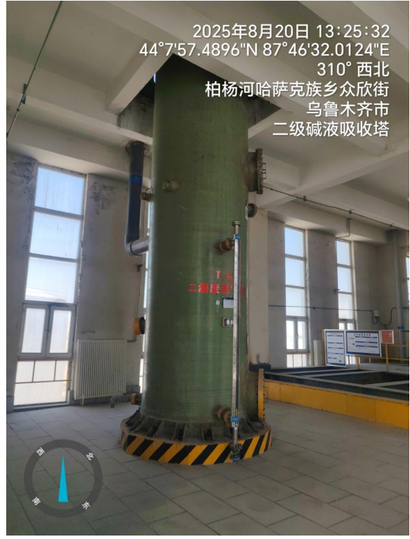
二级碱液吸收塔
