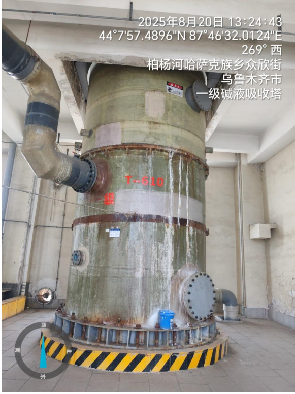
一级碱液吸收塔
